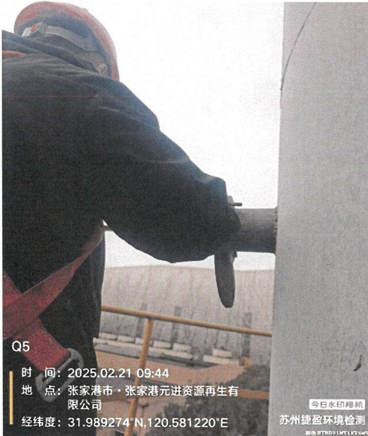
采样点位: 排气筒 5#出口 Q5
