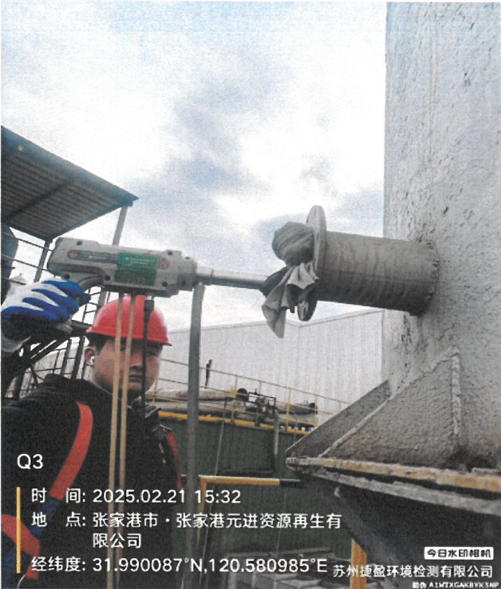
采样点位: 排气筒 3#出口 Q3
