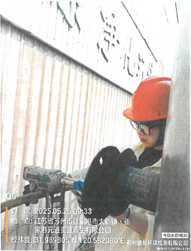
采样点位：排气筒 6#出口 Q6
